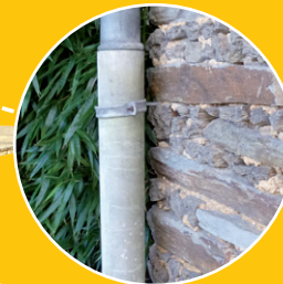
descente eaux pluviales/ eaux usées
