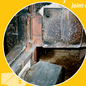
joint de chaudière
