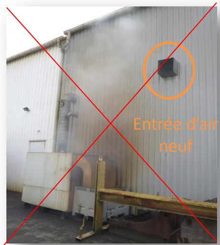
Rejet à proximité d'une entrée d'air neuf
